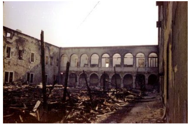
Figura 3. Escola Politécnica – Jardineta após o incêndio de 1978. Cortesia de José Augusto Cardoso.
