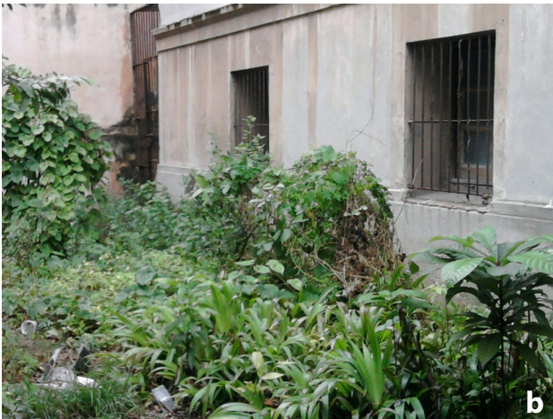
Figura 6. Incidencia de la humedad externa en los depósitos del semisótano. a) Formación de sales de calcio y desarrollo fúngico en la pared de un depósito a consecuencia de la humedad. b) Desarrollo de la vegetación en el exterior de los depósitos durante los primeros meses del 2011 que mantiene la humedad interior.
