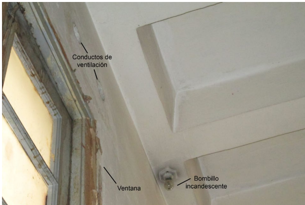
Figura 10. Bombillos incandescentes colocados en el techo de los depósitos del ARNAC cerca de los conductos de ventilación.
